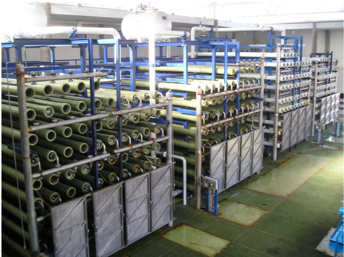
Figura 3. Visión de los 4 bastidores de ósmosis inversa (de izada. a dcha. nº 1 a 4).
