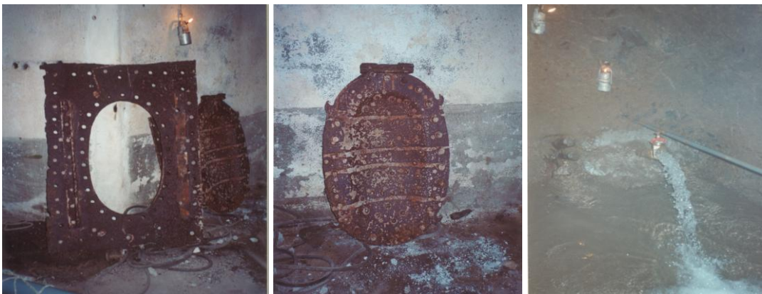
Figura 46. Arriba (izda.): Muro de bloques precintado por la Administración para impedir el paso a un tramo de galería que se ha declarado clandestino. Arriba (drcha.): muro de hormigón armado, complementado con manómetros y dispositivo hidráulico para controlar la salida del agua. (Fte: CIATF). Abajo: Armazón de cierre de compuerta y detalle de ésta. (Fte: Cdad. Unión Norte) y muro de hormigón con dispositivos de desagüe. Al menos, 26 galerías han dispuesto de «cierres» para controlar sus aprovechamientos.
