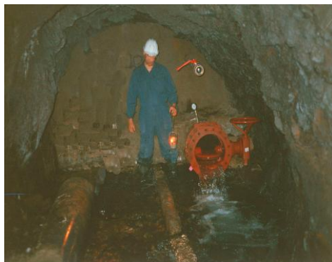
Figura 351. El muro de cirre disponía de dispositivos de desagüe y de medidas de presión del agua en su trasdós.
